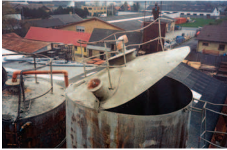
Cementsilo med bristfällig avluftning.
